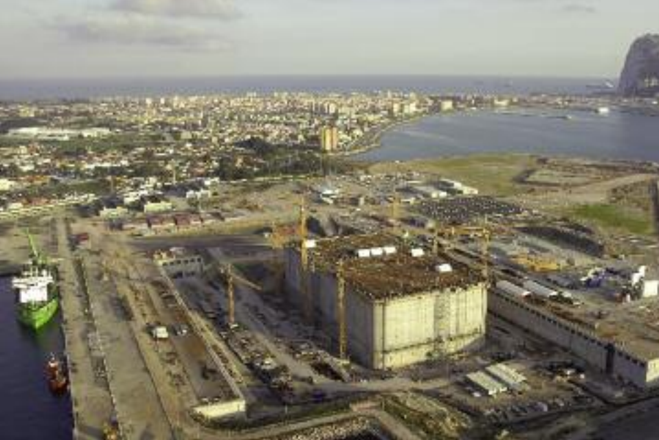
ADRIATIC LNG TERMINAL SPAIN-ITALY
